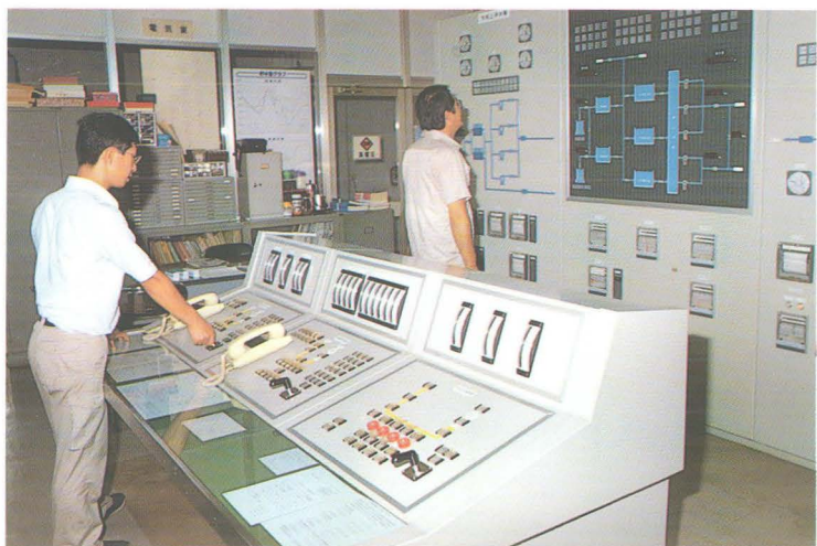
浄水場コントロール室
