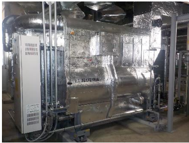
本庁舎吸収式冷温水発生機
