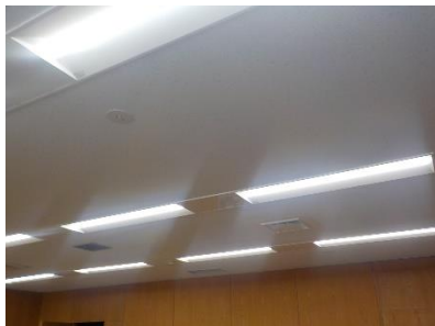
本庁舎照明器具（直管型）
