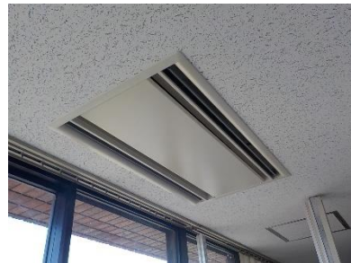
本庁舎ファンコイルユニット
