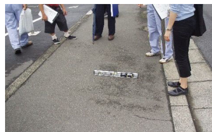
車両乗入部の勾配は20%を超え、歩道が波打っている
