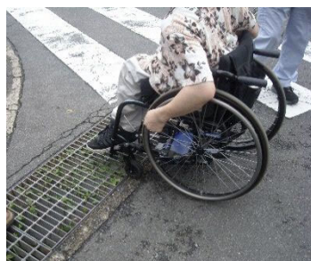
グレーチングの網目が粗く車いすでは通行しにくい
