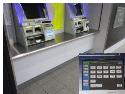
券売機は、利用者の要望に応じて、車いす 対応の蹴込みが整備されている
