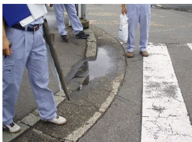
車道との擦り付けで歩道面の勾配が急になっている
