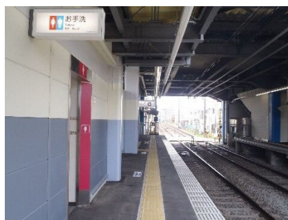
トイレを案内するサインが不足している
