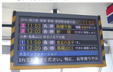
電車の発車案内板が設置されている
