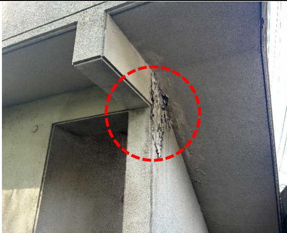
ホワイエ側屋外階段(上裏) 爆裂発生
