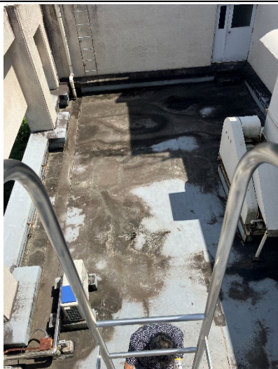
屋上防水 汚れあり
