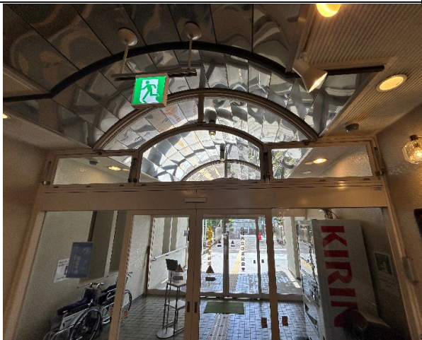
1 階エントランス風除室 排煙窓 開閉不良
