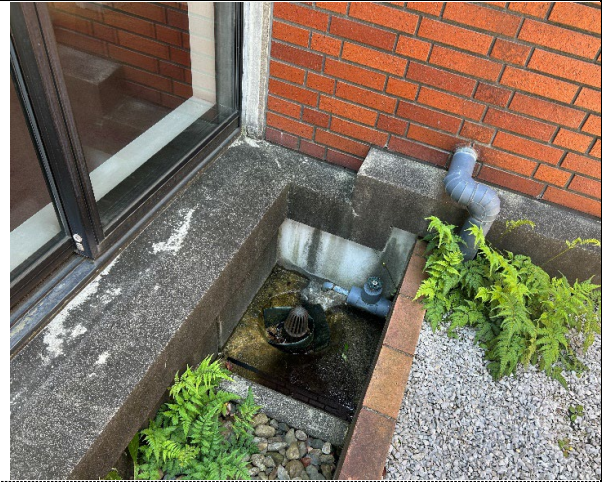
3階屋上ルーフトレン詰まり 1階親子室の漏水原因の可能性あり
