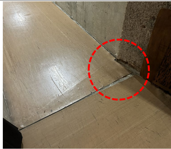
1階大ホール舞台裏床 湿気による床材の劣化
