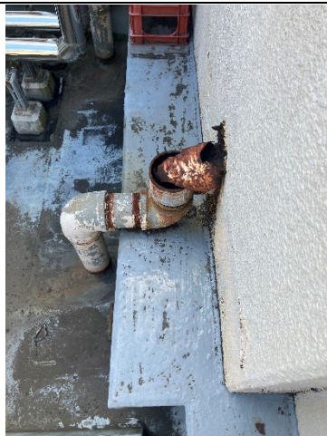
屋上排管 錆による腐食
