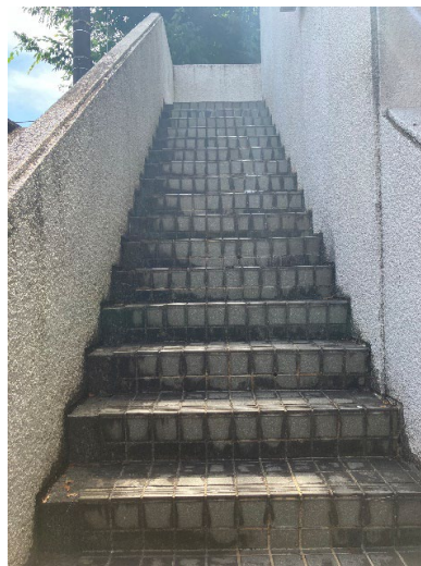
ホワイエ側屋外階段 汚れあり
