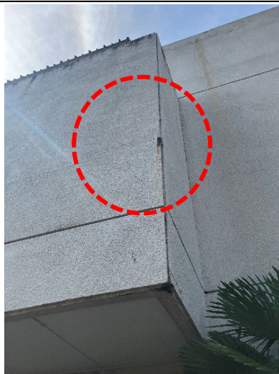
屋外階段横外壁 塗膜の剥がれ
