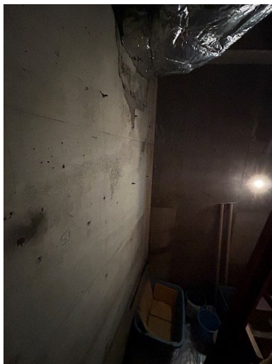
ホールキャットウォーク 雨漏りあり
