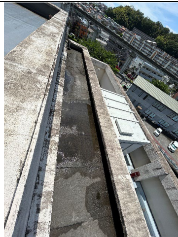
2 階屋上ルーフドレン 排水不良
