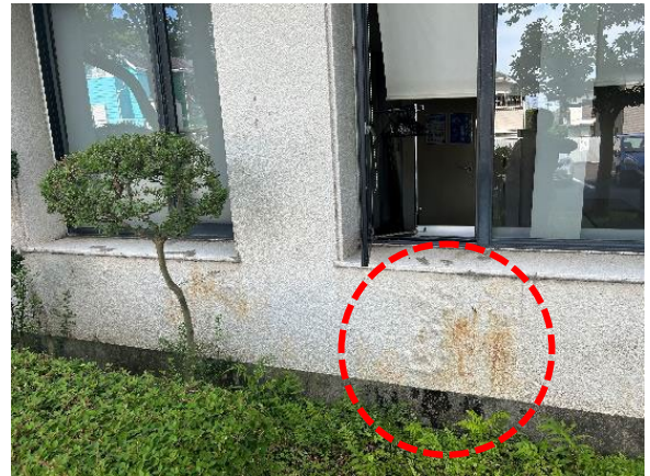
1階東側外壁 塗膜の浮きおよび錆汁の発生
