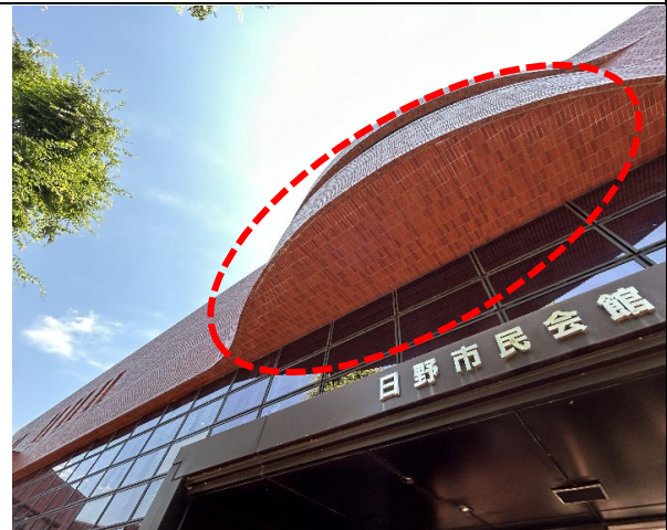
正面玄関バルコニー外壁(上裏) 白華現象
